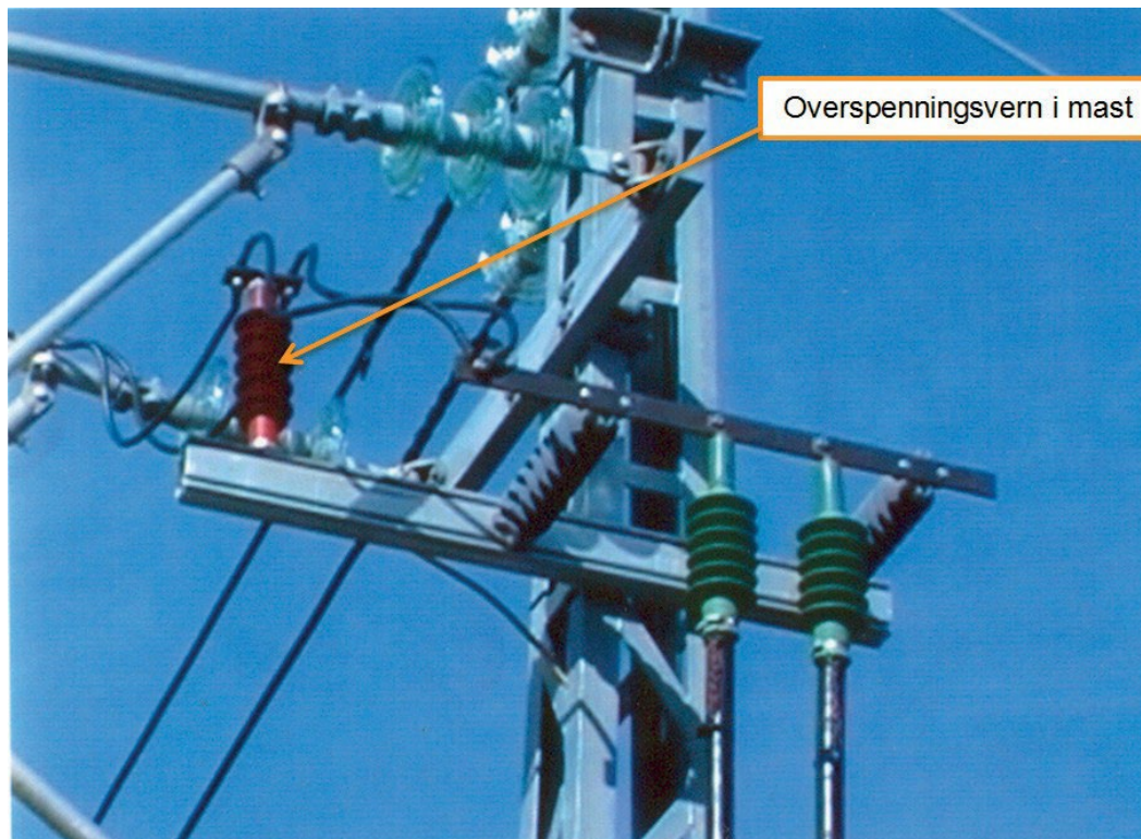
Figur 18.10 Overspenningsvern som beskytter kablene
