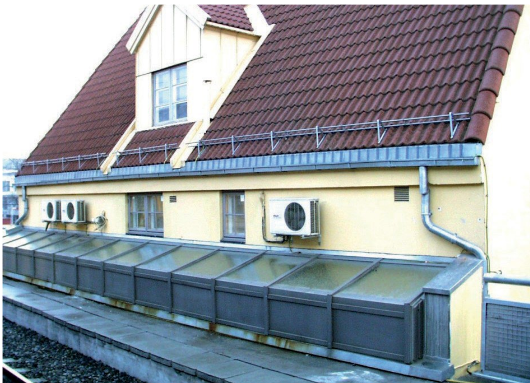
Figur 20.33 synlig jordleder av takrenner, nedløp og skjerm
