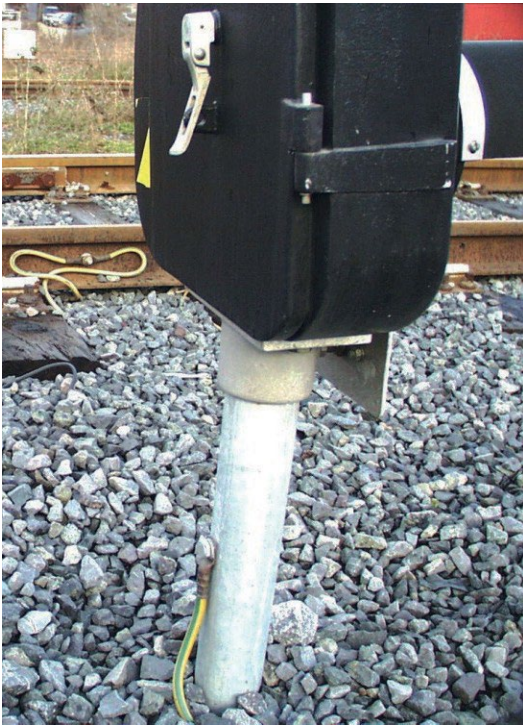
Figur 20.10 Feil utførelse, brukt kobberkabelsko ved jording av dverg. På galvaniserte flater skal det benyttes fortinnede kabelsko eller cupalblikk
