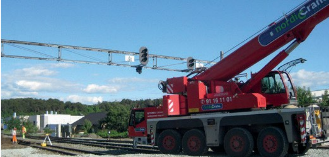
Figur 20.29 Mange eiere av mobilkraner, gravemaskiner o.l. vil at maskinene jordes til sporet ved bruk av "åpen jording" dette for å beskytte maskinens elektronikk fra ikke kontrollert returstrøm
