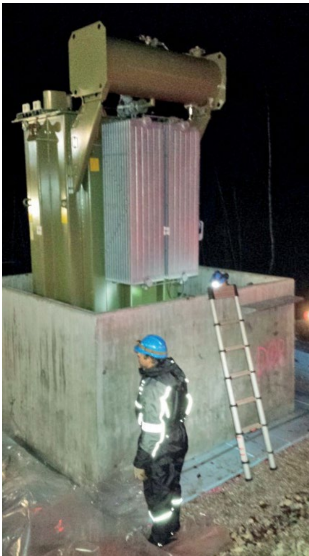
Figur 18.25 Bildet illustrerer størrelsen på en AT- transformator
