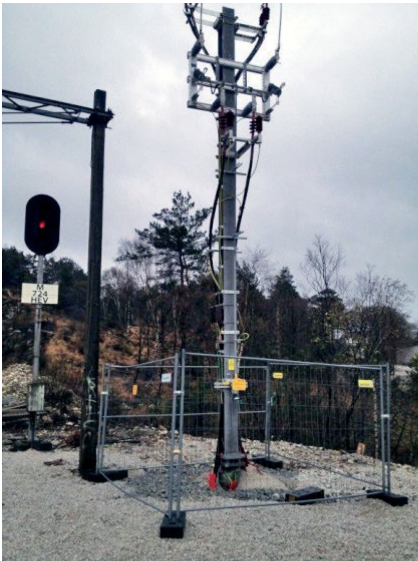
Figur 18.23 Bryterarrangement ved AT-transformator
