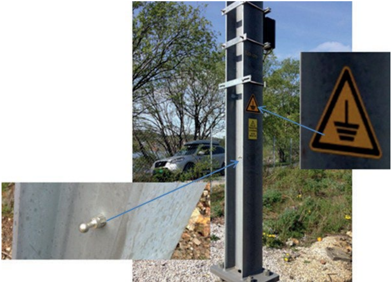
Figur 17.24 Mast med jordingskule og skilt
