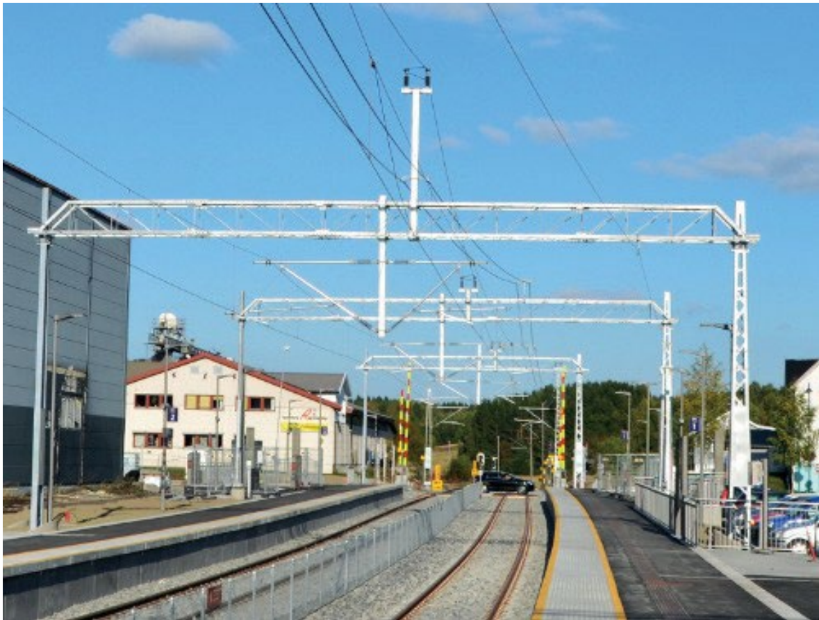
Figur 14.25 Hengemaster og spir montert i åk Spydeberg stasjon
