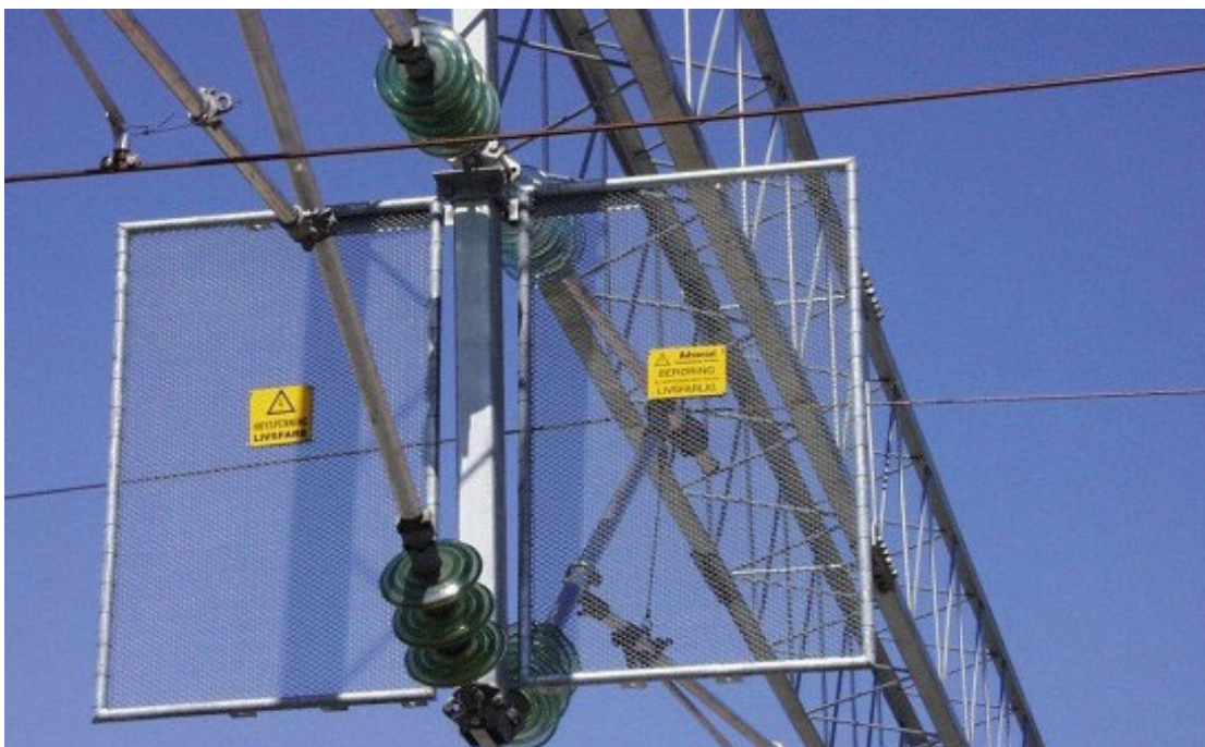
Figur 6.8 Beskyttelsesskjermer montert på hengemast
