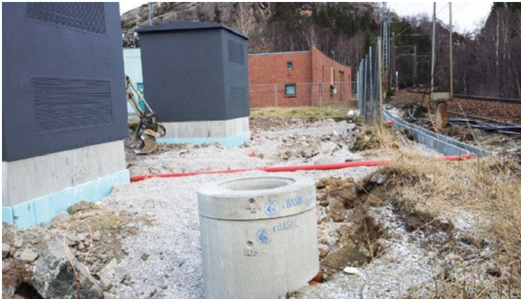
Figur 4.39 Kiosker med autotransformator, bilde fra Kielland
