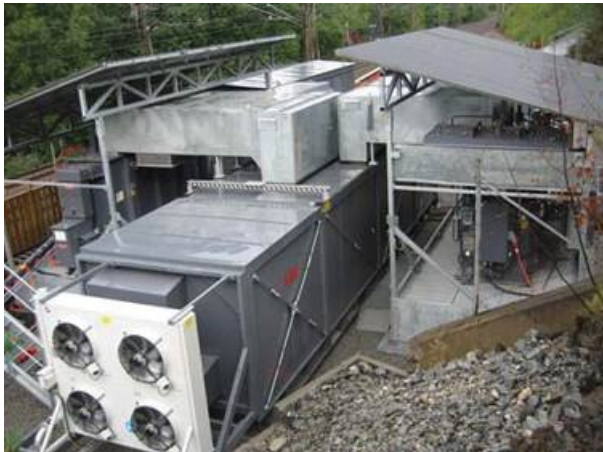
Figur 4.5 Mobil statisk omformer på Holmlia i Oslo. Hoveddelen av den mobile omformeren er det som er i containeren
