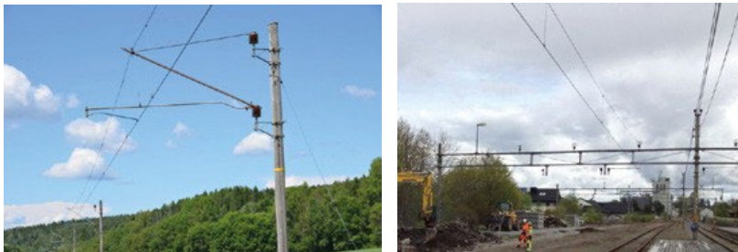
Figur 5.18 Kontaktledningssystem bygget etter tabell 54
