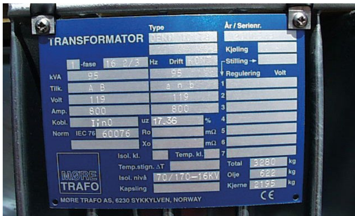
Figur 10.2 Eksempel på transformator merkeskilt
