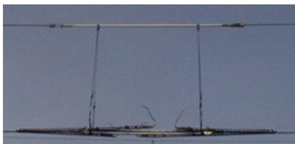
Figur 4.35 Eksempel på seksjonsisolator
