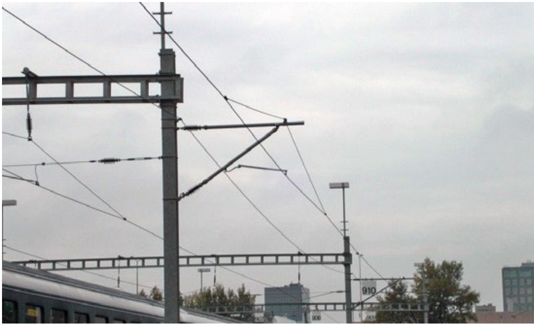
Figur 5.17 Kontaktledningssystem utført med Deltaledning
