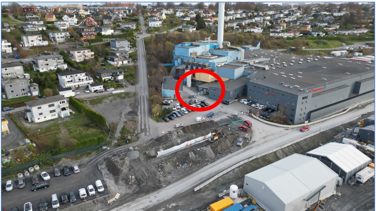
Arbeidet med å forberede påkobling er i gang (midt i bildet), mens arbeidet i neste uke skal foregå innenfor den røde sirkelen.
